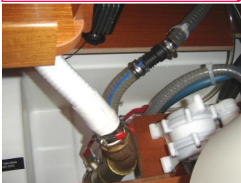
Ventile Pantry Spüle: Fußpumpe → See- / Frischwasser
