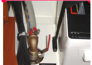
Seeventil und Seewasserfilter Maschine
