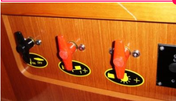
Hauptschalter Elektrik [Cabin Bb]
