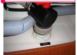
Seeventil Brauchwasser [Cabin Stb, Schrank]
